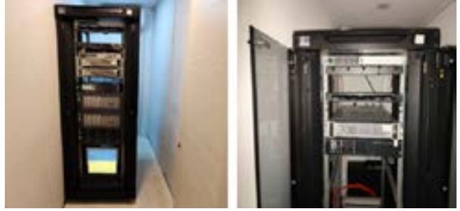
Yedek Sistem Odası Felaket Kurtarma Merkezi Sistem Altyapı Çalışması
